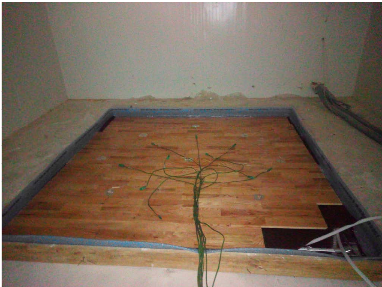
Sistema Uponor 49 mm. Conexiones de termopares en el suelo.
